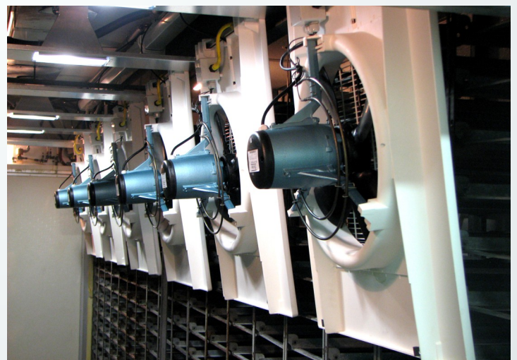
Resistencia de calefacción y sistema de humedad Cyclomist montados en el ensamble del tablero plástico de ventiladores
